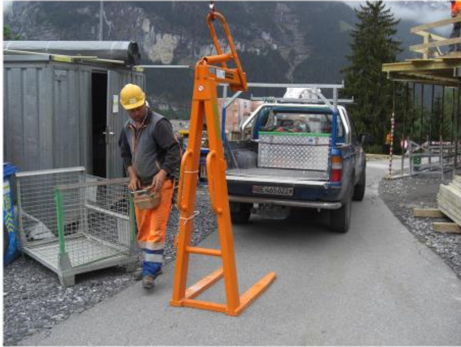
写真—33 定置式クレーンが設置されたスイスの工事現場（著者撮影） （ベルトに固定した無線操作盤でフォーク型吊り治具を操作）
