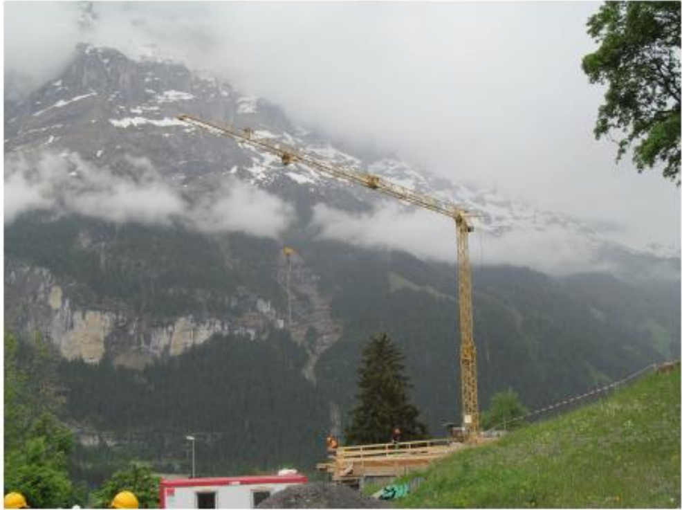
写真一 1 4 定置式クレーンを設置したスイスの小規模な工事現場の一例 (著者撮影)
