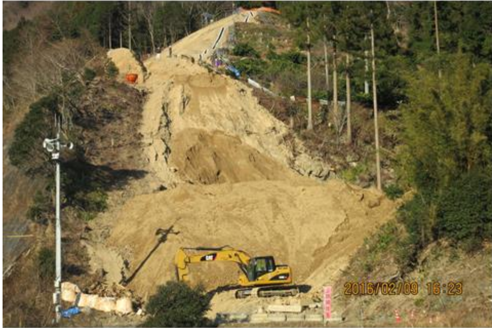
写真一五〇 定置式クレーンが設置されていない日本の工事現場 (著者撮影；高知県四万十市付近の災害復旧工事) (斜面走行するユンボのクレーン使用の常態化)
