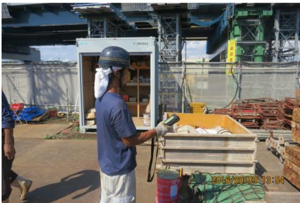
写真一 2 0 日本 の 定 置 式 クレーン が 設 置 さ れ た 工 事 現 場 （ 著 者 撮 影 ） （ 無 線 操 作 盤 を 操 作 中 ）
