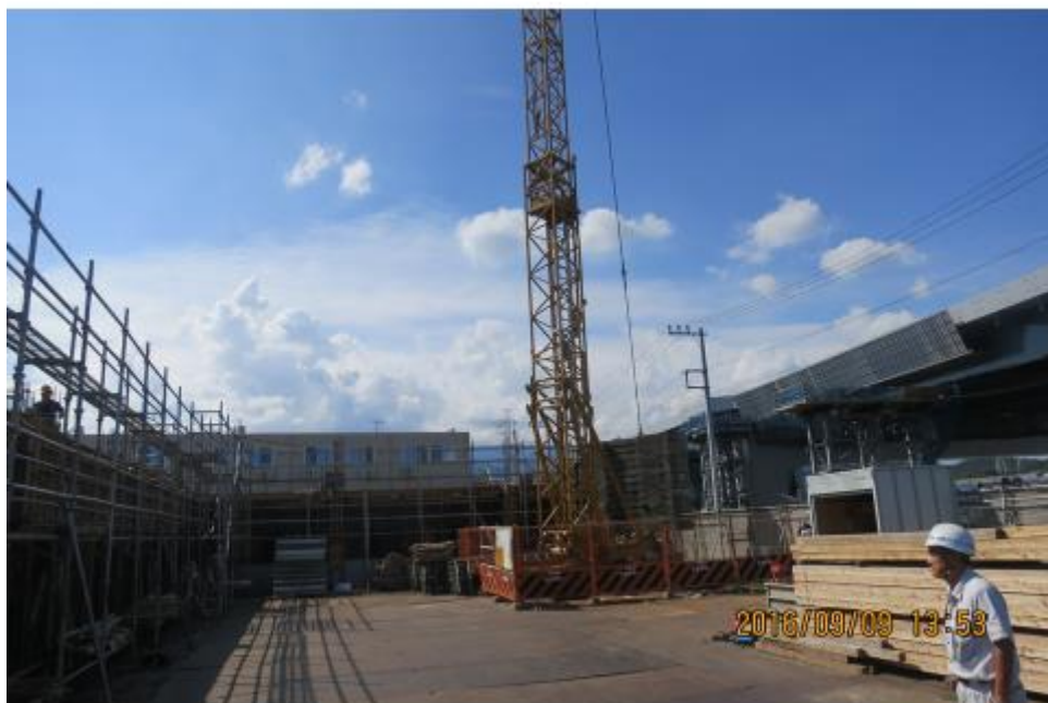
写真一 1 7 日本の定置式クレーンが設置された工事現場（著者撮影）
