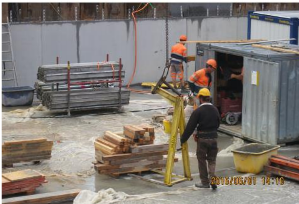
写真—3 2 定置式クレーンが設置されたスイスの工事現場（著者撮影） （べるとのに固定した無線操作盤でフォーク型吊り治具を操作）
