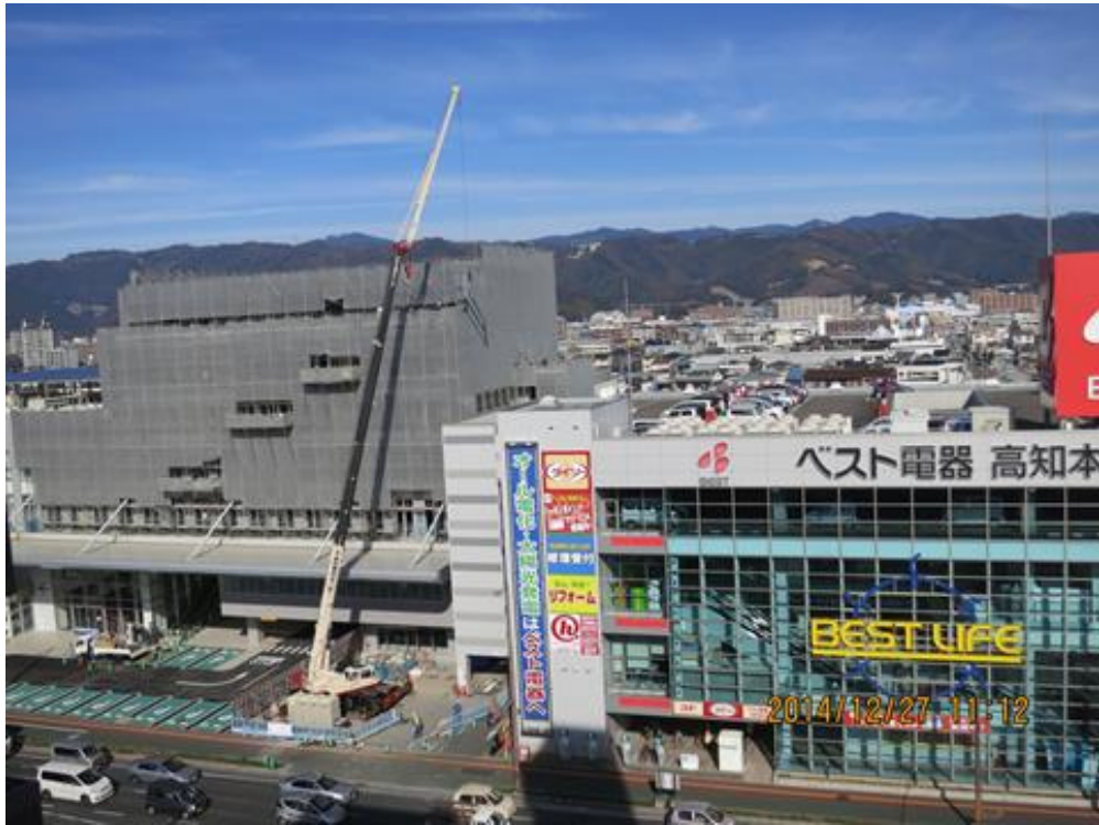
写真一八 日本の工事現場の標準的な移動式クレーンの使用方法（高知市内） （著者撮影）
