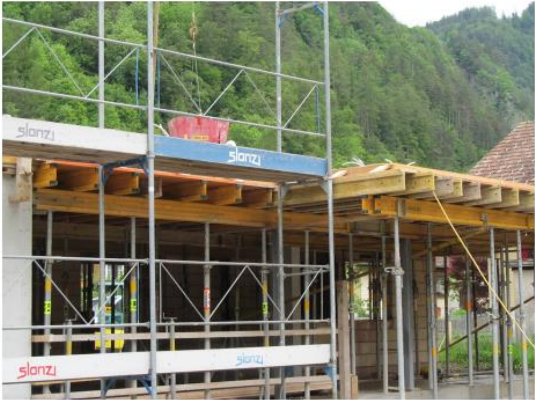
写真ー 2 5 定置式クレーンが設置されたスイスの工事現場（著者撮影） （型枠の厚さは、1インチ、I型木製ビーム）
