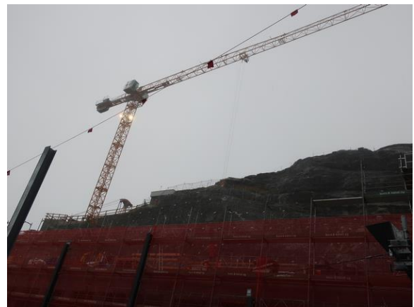
岩盤にアンカーボルトで固定された定置式水平ジブクレーン
