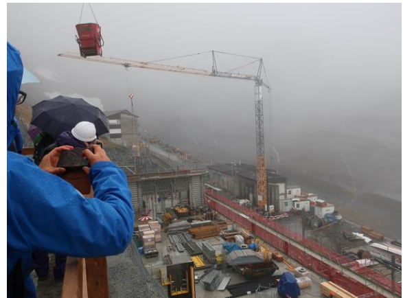
置き基礎形式の定置式水平ジブクレーン
