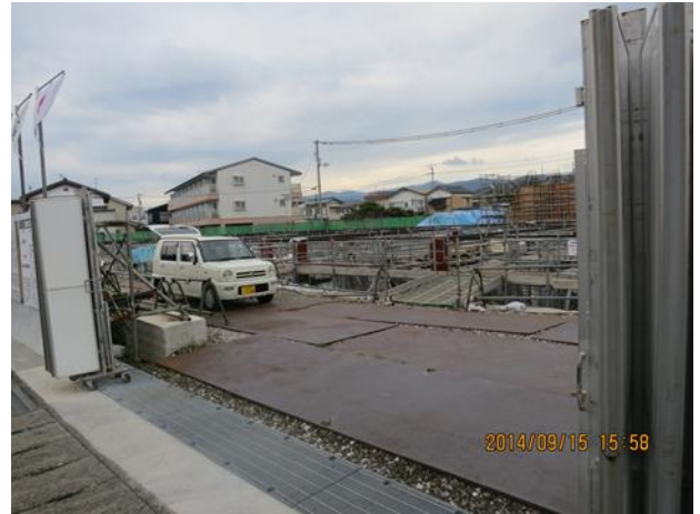
写真 7 香美市消防署新築工事現場 (クレーンがない状況) (著者撮影)
