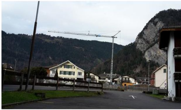
写真 9 インターラーケン市近郊の建設現場 (定置式クレーンが設置) (撮影; エッター部長)
