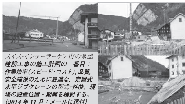
写真2 スイスの常識（ユルグ・エッター撮影）
